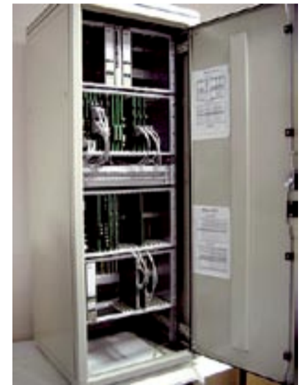
Рис. 3. Большой потребитель тантала – телекоммуникационные сети. Шкаф телекоммуникационного оборудования
